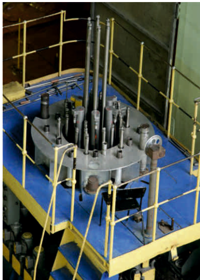
Площадка размещения приводов СУЗ
