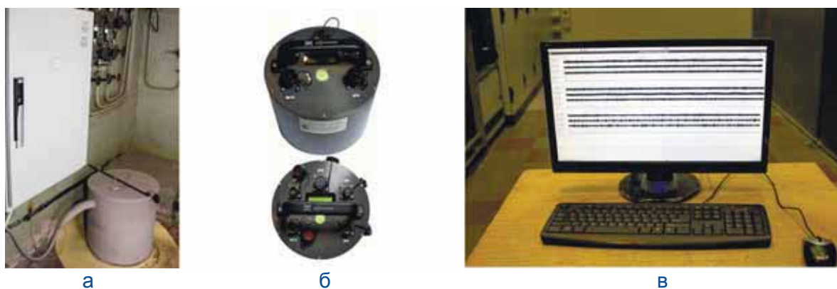
Рис. 1.75. Внешний вид аппаратуры системы промышленной антисейсмической защиты: а — сейсмодатчик в защитном кожухе; б — акселерометр CMG-5TD-M; в — рабочее место оператора
