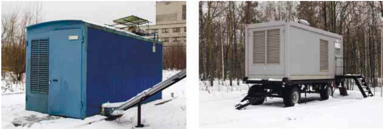
а б Рис. 1.76. Внешний вид стационарной (а) и передвижной (б) дизельной электростанции
