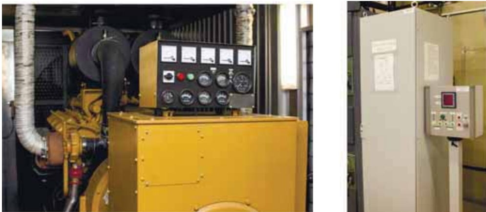
а б Рис. 1.77. Внешний вид местного (а) и дистанционного (б) поста управления дизельной электростанции
